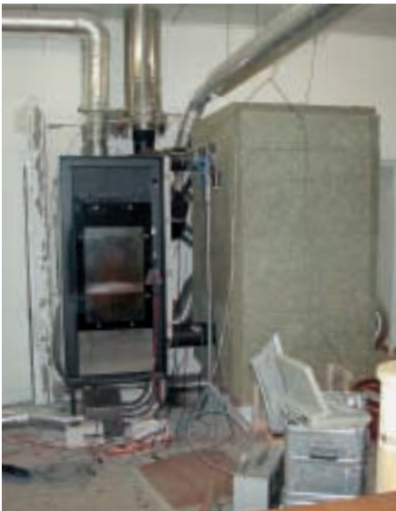
Pilotanlage für Wärmeerzeuger und Speicher
