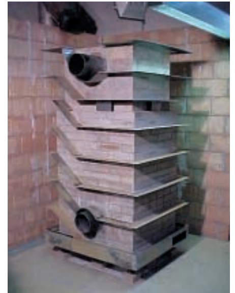
Steinspeicher ohne Ummantelung
