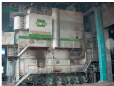
Rostöfen in einer KVA in Peking
