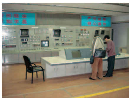
Steuerzentrale einer KVA in Shenzhen
