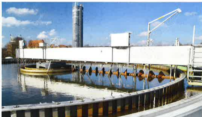
Gewässerschutz: Oberflächenwasser-Aufbereitungsanlage in Berlin-Tegel
