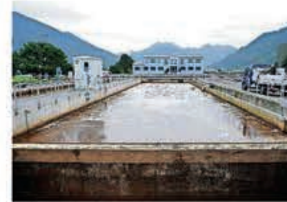
Die Kläranlage in Bilten.
