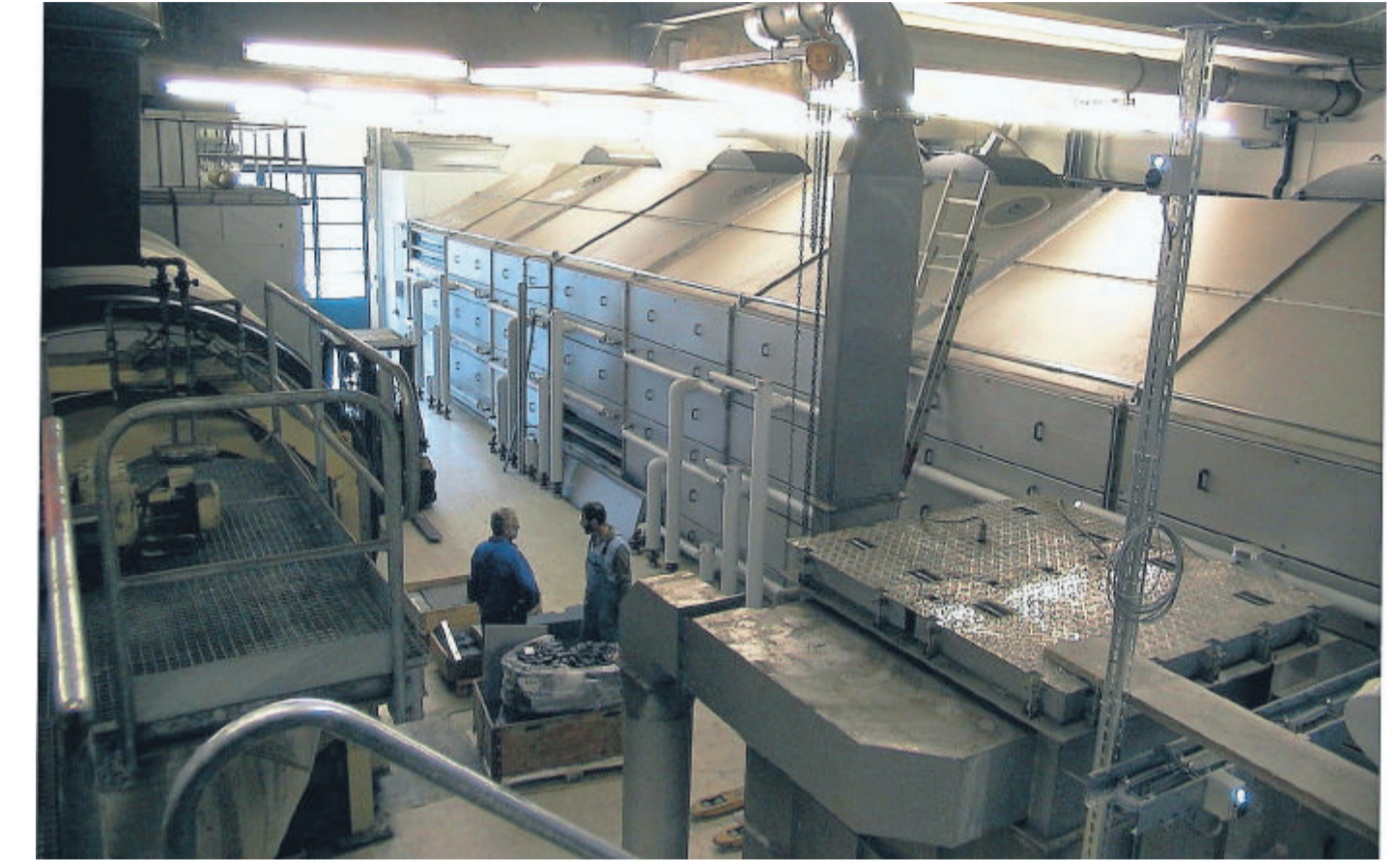
Die Band-trocknungsanlage in der ARA Altenrhein hat die Kinderkrankheiten überstanden. Wird Schlamm getrocknet, stinkt es nicht mehr. Bild: AVA Altenrhein
