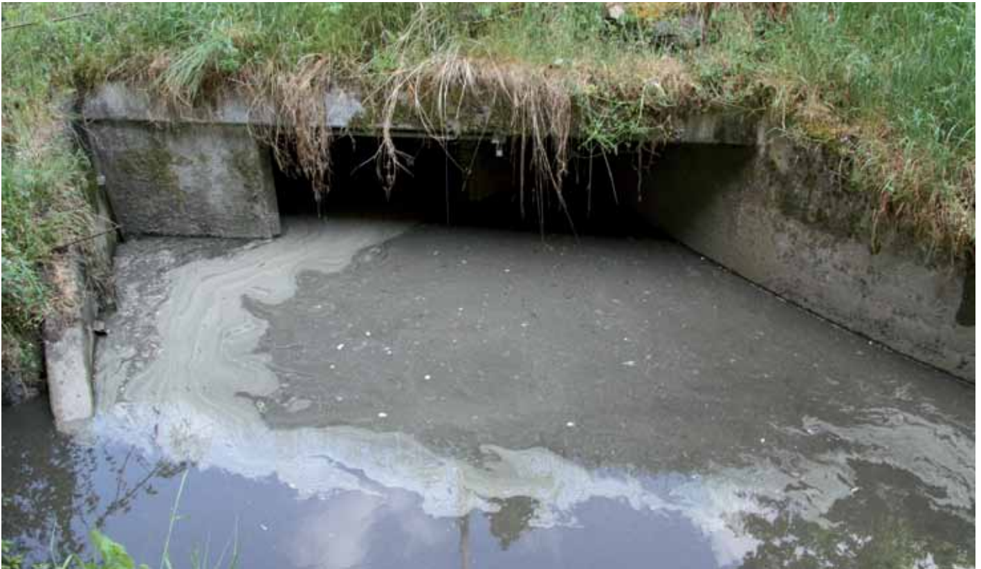
Bild oben: Oberflächlich abfließendes Regenabwasser wird oft ohne vorherige Behandlung in kleine Fließgewässer eingeleitet.
