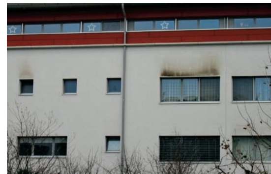
Fehlende oder kleine Dachvorsprünge begünstigen die Algenbildung. Oft findet sich Algenbefall auch oberhalb von Kippfenstern, weil die warme Luft auf der Fassade kondensiert.
