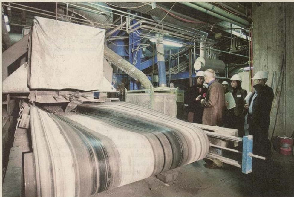
Die Anlage für den Trockenaustrag in der Kehrichtverbrennungsanlage Zürcher Oberland. CHRISTIAN BEUTLER
