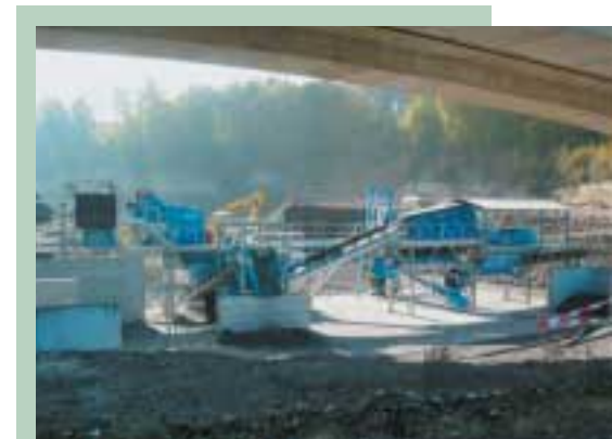
Die neue Schlackenaufbereitungsanlage ist ökologisch und ökonomisch sinnvoll.
