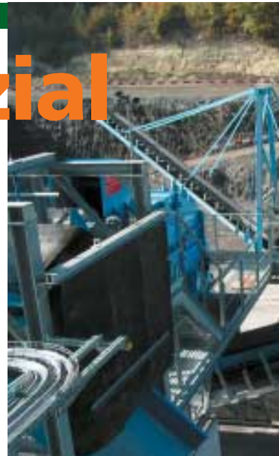
Die Schlackenaufbereitungsanlage wurde modernisiert.
