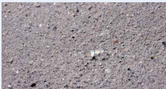
Bild 1: Betonoberfläche mit sehr vielen Poren
