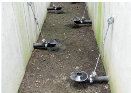
Abbildung 1 zeigt die Regenabwasserbehandlung mittels eines synthetischen Adsorbers, bevor das Wasser direkt in den Grundwasserleiter versickert wird.
