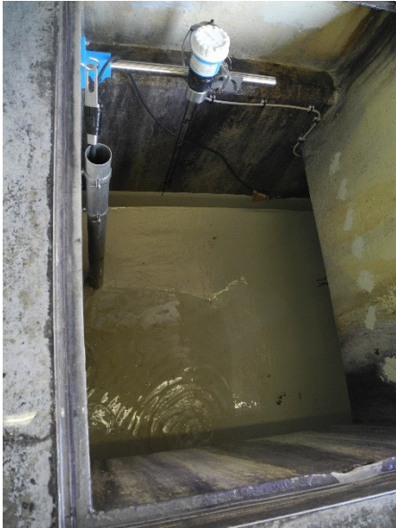
Abbildung 2; T55, Belüftungsbecken auf der T55 Toilettenstation
