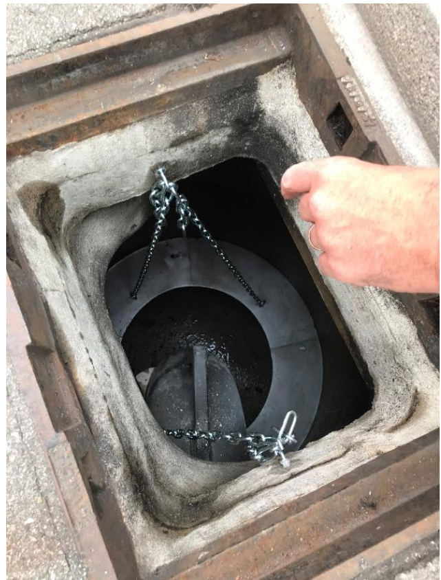
Abbildung 3: Eingebauter Prototyp der Nachrüsteinheit im Schlamm-sammler
