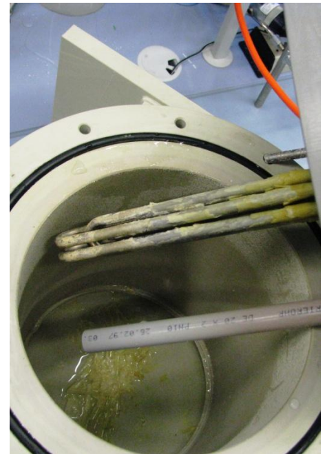
Abbildung 2: „Steinausfällungen“ nach 3 Wochen ohne Behandlungsanlage an Heizung und Boiler
