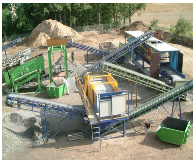
Abb. 2: Anlage zur Schlackenaufbereitung
