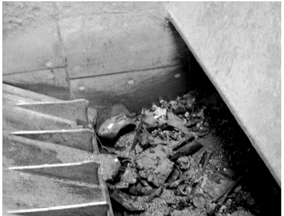
Abb. 1: Trocken betriebener Nassentschlacker
