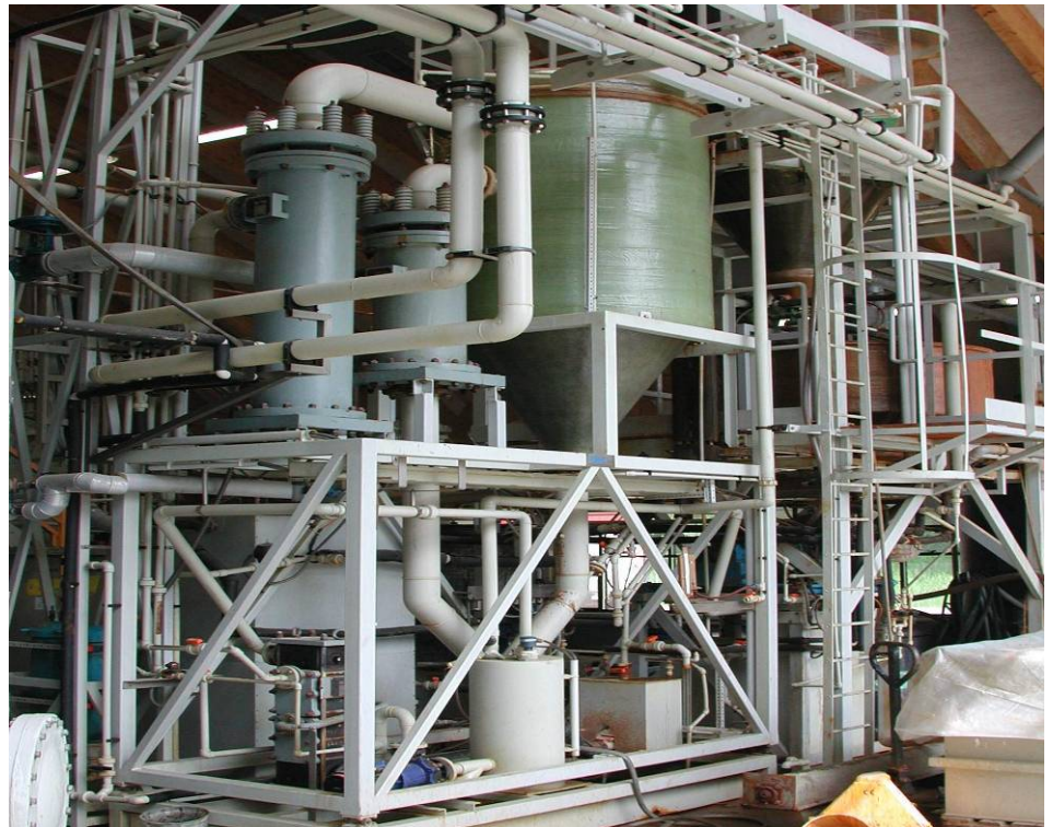
Abb. 1: Ausschnitt aus der GALVASPLIT-Anlage bei Thommen-Furler AG in La Chaux-de-Fonds
