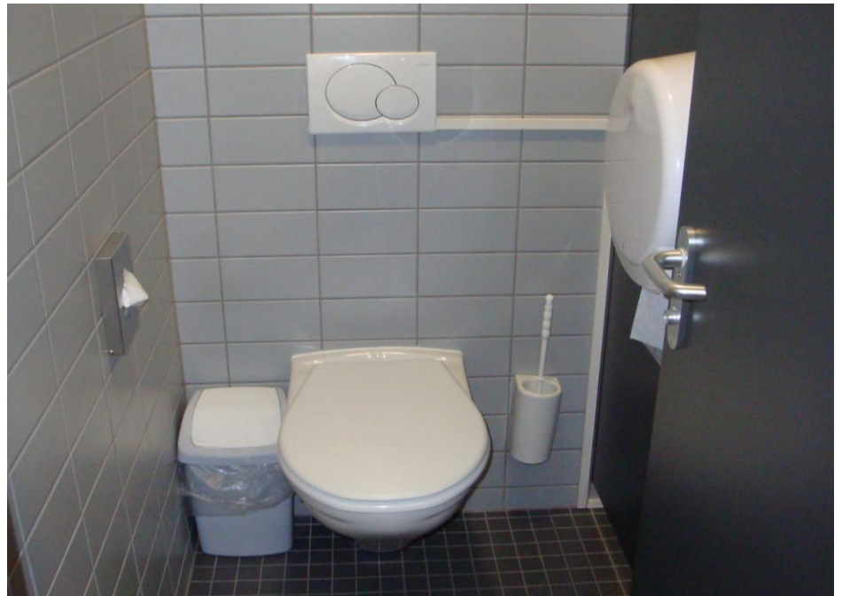
Abb. 1: Steuerung grosse/kleine Spülung anhand des Papierverbrauchs
