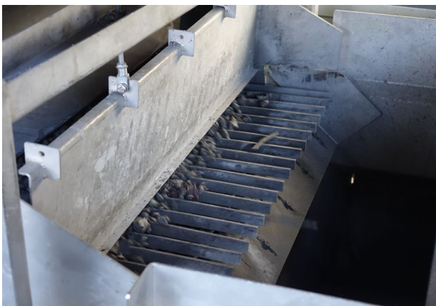
Abb. 4: Querulator installiert in einer MVA-Schlackenaufbereitung. Blick auf die Ablenkvorrichtung und den Austragsrechen.
